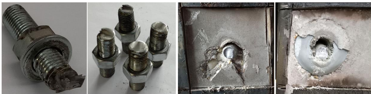
6. ábra: Csavarok tönkremenetele (bal), betonrepedés és habarcskitöltés a csavar alakváltozásával (jobb)
